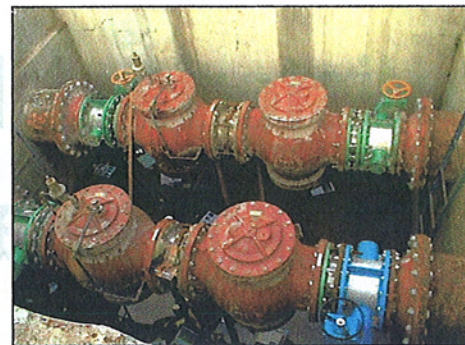
[Figura 5] Válvulas reductoras y filtros Ross en paralelo.
